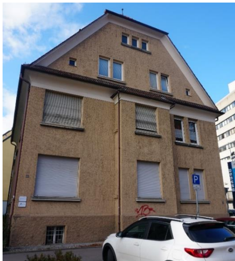
Abbildung 22: Modernisierungsbedürftiges Gebäude, Helmut-Bornefeld-Straße 18 (Bußgeldstelle) (Quelle: WHS, November 2020)
