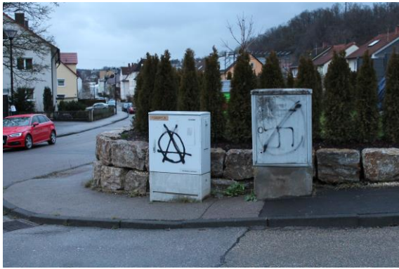
Abbildung 41: Graffitibesprühungen in der Humboldtstraße (Quelle: WHS, 2016)
