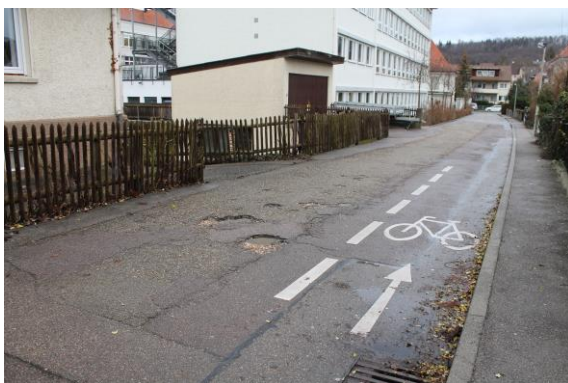
Abbildung 45: Schlechter Straßenzustand in der Hans-Sachs-Straße (Quelle: WHS, 2016)
